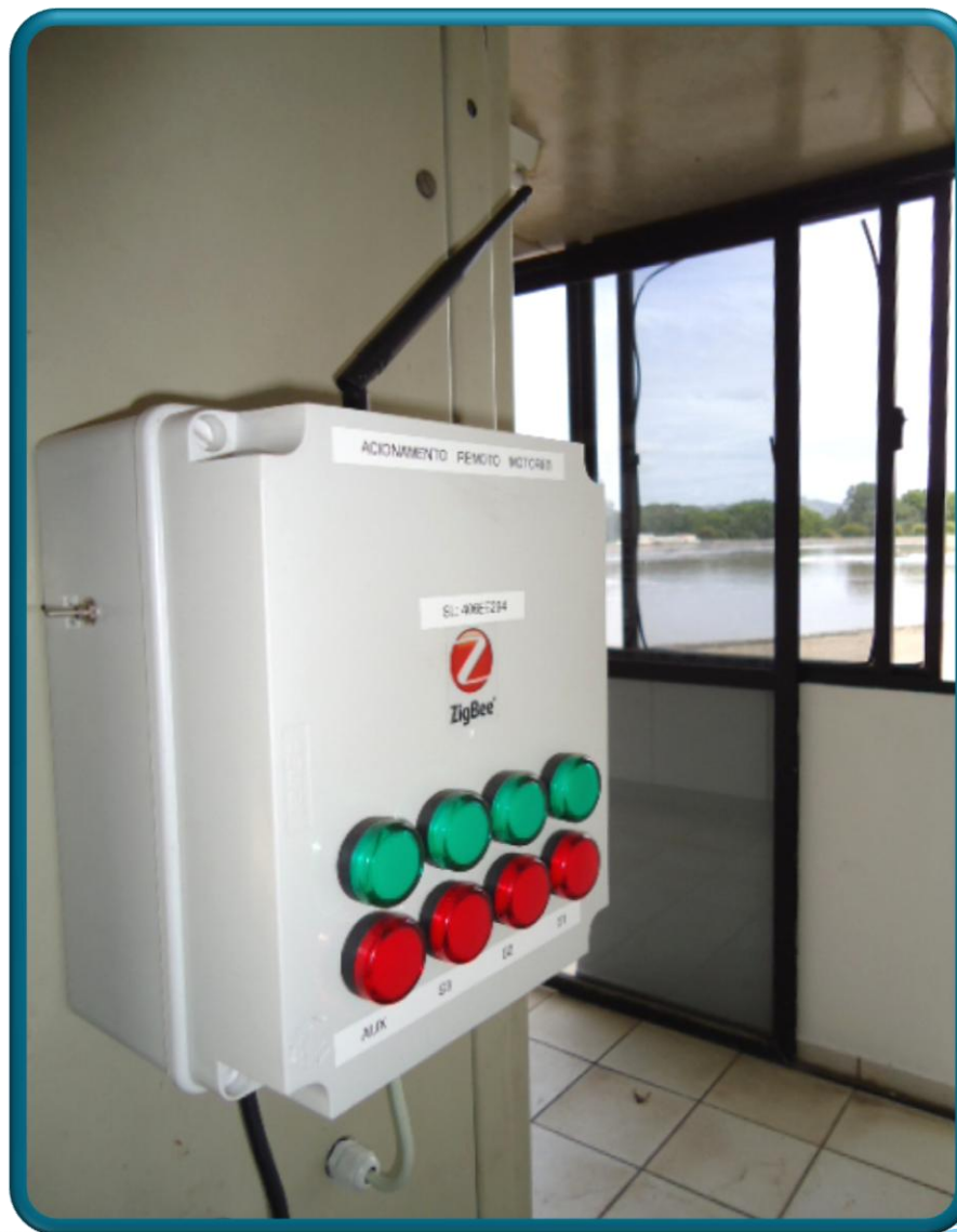
Módulo de potência instalado no painel
