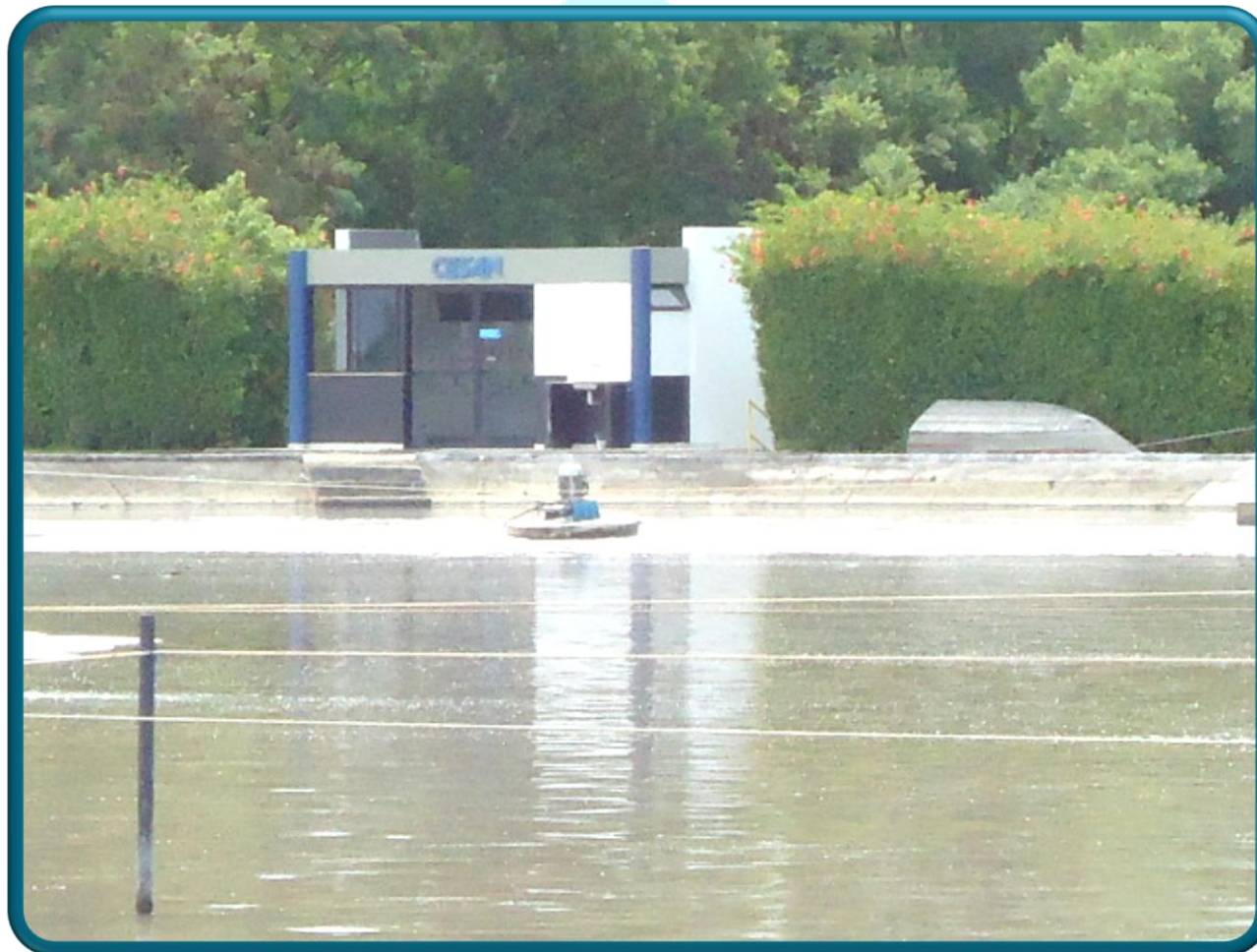
Detalhe da Sala Elétrica da estação
